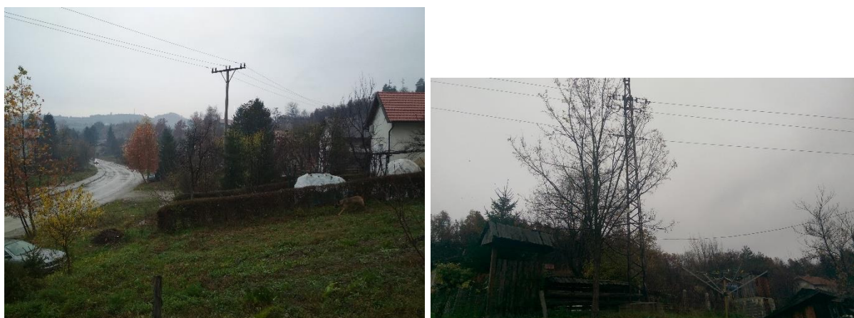
SLIKA 4 – ZATEČENO STANJE ELEKTROENERGETSKOG VODA 35kV (terenski obilazak dana 12.11.2019.)
